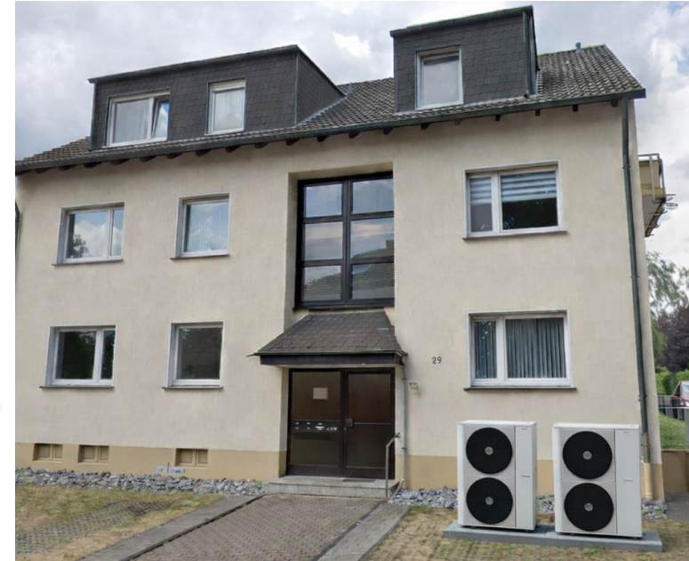
fiktives Beispiel: Luftwärmepumpen vor einem Altbau in der Märkischen Straße
