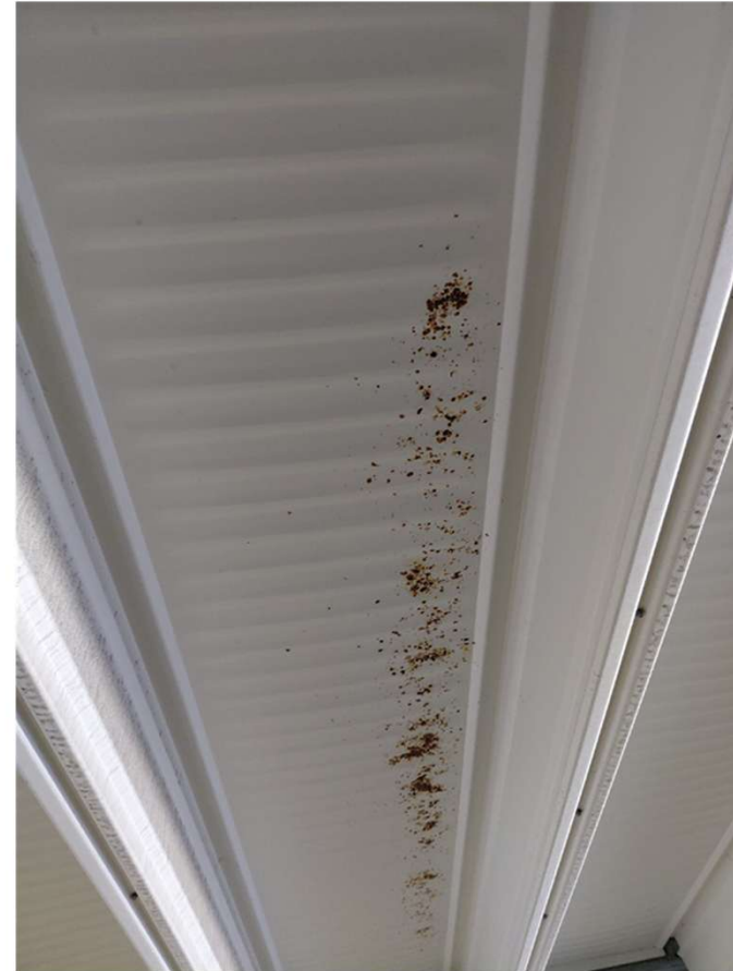
Ist-Zustand / Schadensbild Lineare Schädigung am Blech (Rissbereich)
